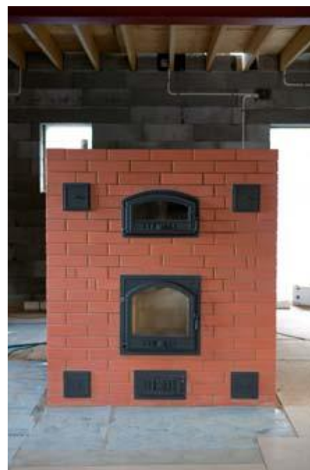
Huset värms med en bastant vattenmantlad rysk massugn. Foto: Felicia Oreholm
