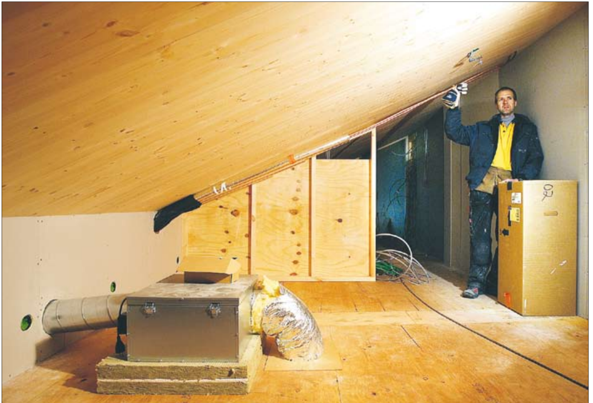
Huset är försett med ett stort loft där det finns plats för tv-rum, men också för solvärmare, värmeväxlare, kablar och sladdar. De 30 centimeter tjocka väggarna har luckor i väggarna för att man ska kunna mäta fukt och temperatur och kolla hur de isolerar.
