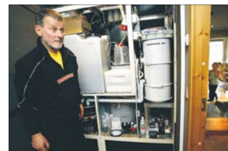
Björn Ödman har världens första Splitbox i sitt nybyggda ekohus vid Dyket i Kvissleby. Anläggningen är ett finurligt system för att återvinna energi och vatten samt ta hand om familjens avfall från både kök och toalett. En gång i månaden behöver vi tömma avfallstanken, det tar inte ens tio minuter, säger Björn Ödman.
